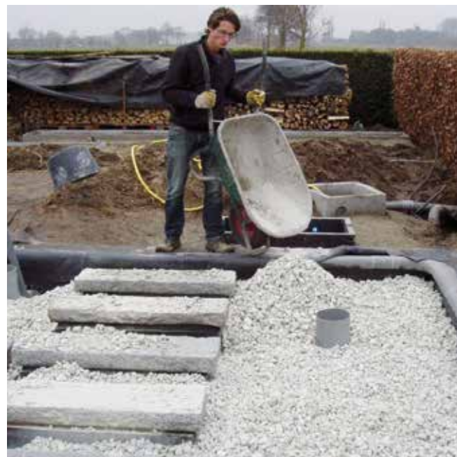
Filterzone bestaande uit substraatbed met geselecteerde waterplanten.
