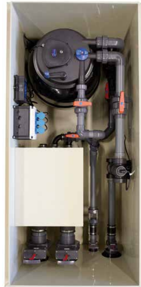
Techniekput met boogzeef en drukfilter.
